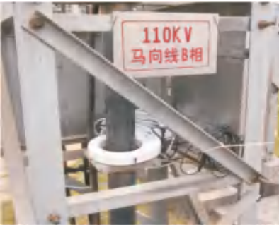
监测主缆运行电流的电流互感器
