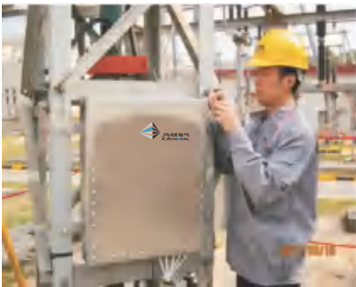
某户外杆塔安装集中控制单元
